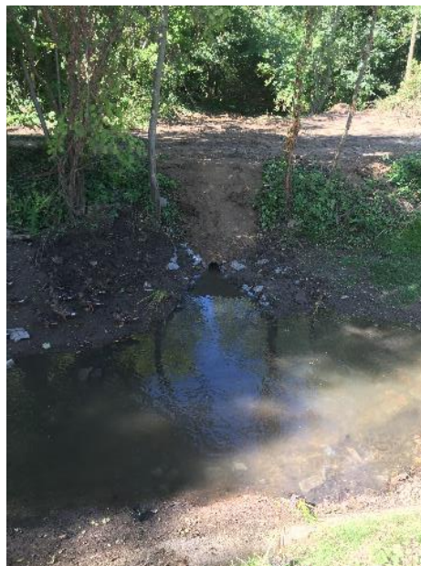
Ajustement de la prise d'eau d'un étang
