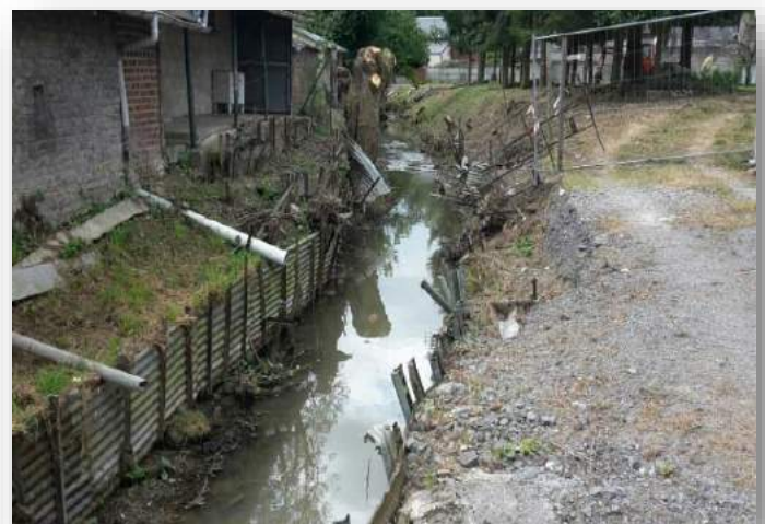
Protections de berges inadaptées
