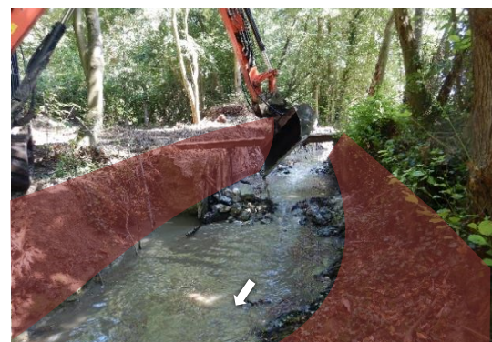
Berges à reprofiler et végétaliser
