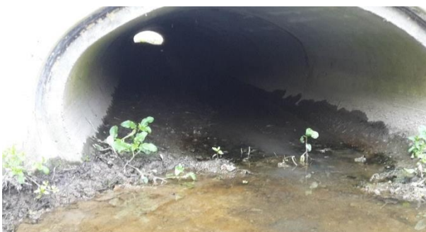
Sédiments en excès sous le passage busé
