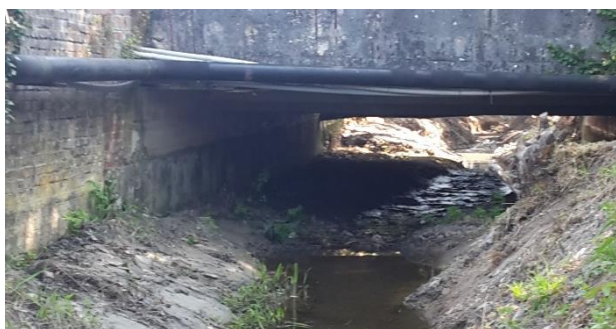
Sédiments en excès sous le pont
